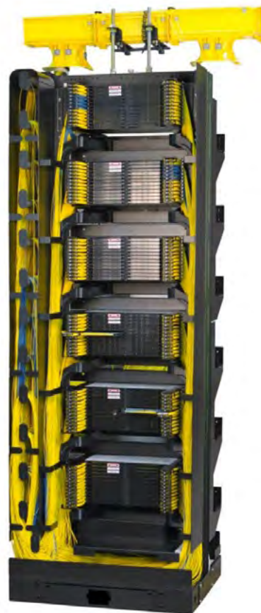
Bastidor de Distribución NG4access (configurado)
